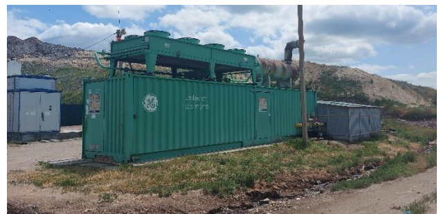
Фото. Когенераційна установка для використання полігонного газу
